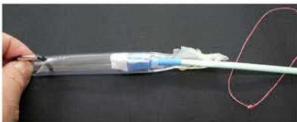
⑧ 縦方向に自己融着テープが分離する
